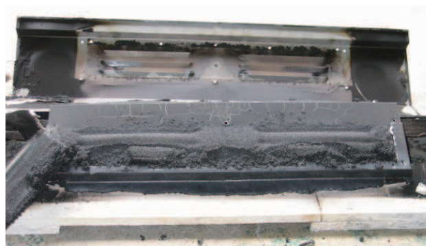
【熱膨張後の換気棟内部】
